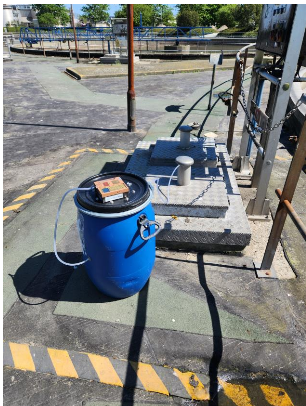
Figur 5. Lugtprøvetagning i udluftningsrør fra rørføringerne ved primære tanke.
