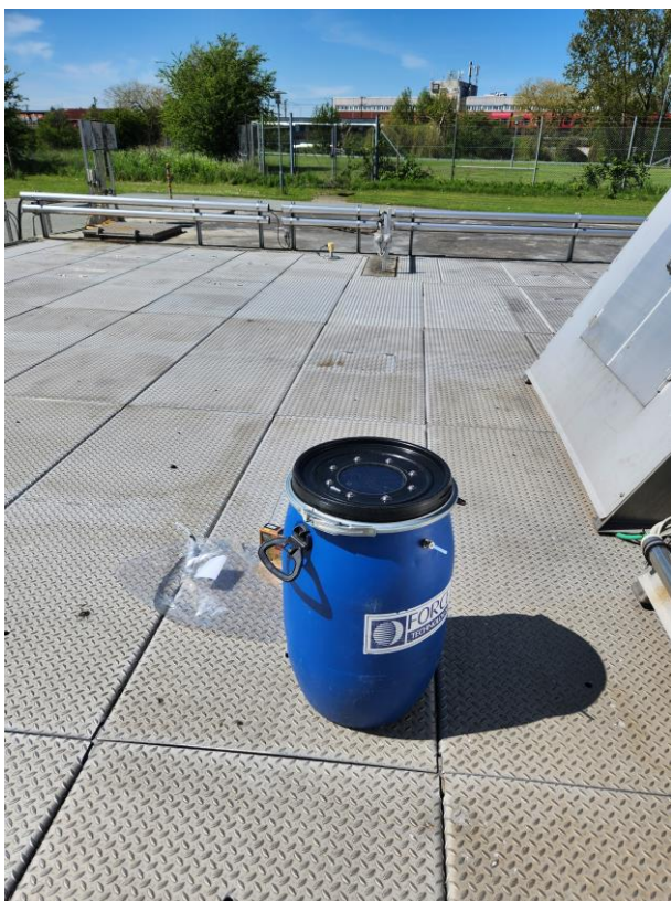
Figur 2. Metalplader over indløb samt lugttønde til prøvetagning.
